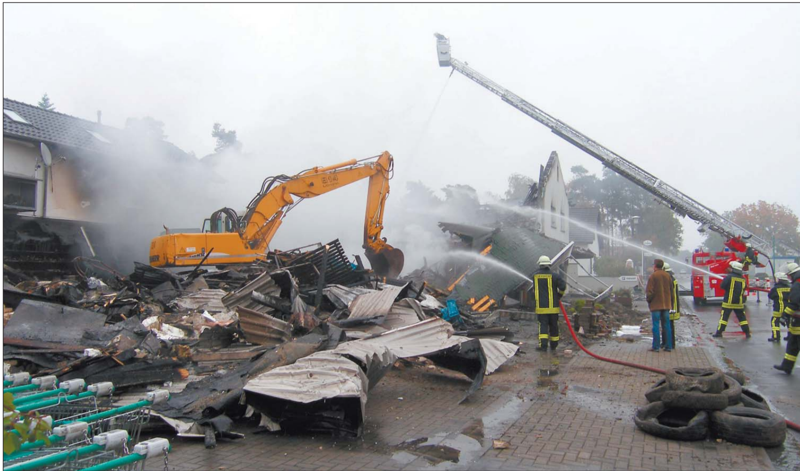
Noch am Sonntagmorgen schlugen immer wieder Flammen aus dem abgebrannten Gebäude, so dass ein Bagger unter Zuführung von Löschwasser die Grundmauern einreißen musste, um an die Brandnester zu gelangen. Fotos: Felix Quebbemann/Feuerwehr Espelkamp
